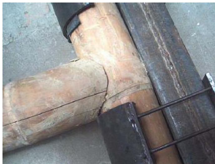
Figura 3.24. Ruptura da Conexão SV 90° por compressão.
