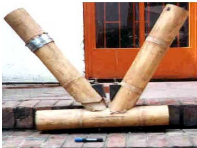
Figura 3.21. Ruptura da conexão SV 60° devido a tração.
