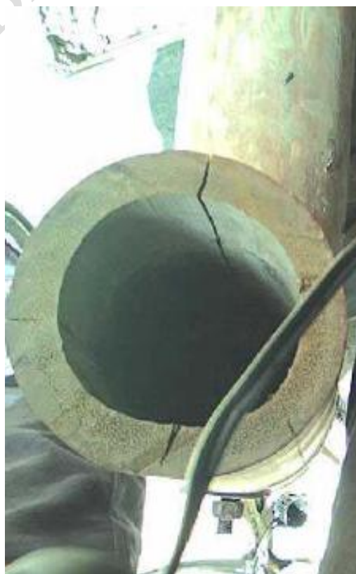
Figura 3.26. Ruptura da Conexão SV 90° por compressão.
